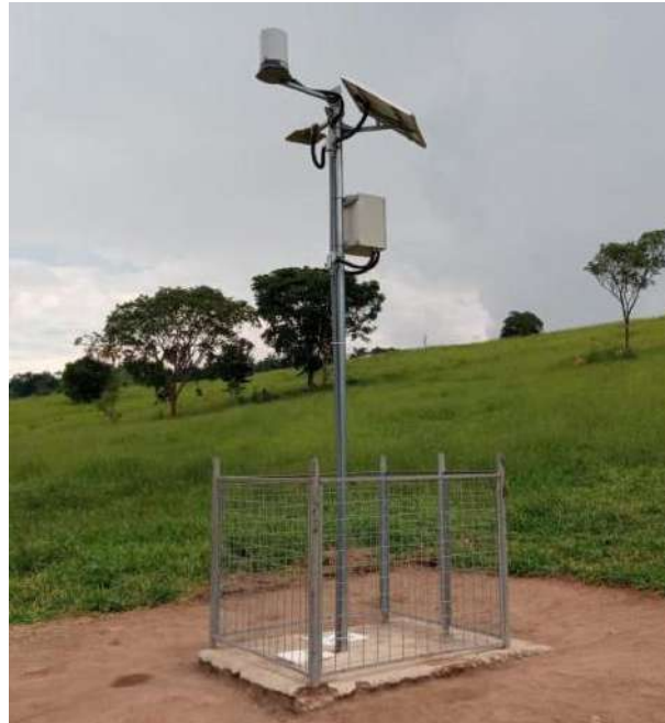
Estação Telemétrica Limpa (perto)
