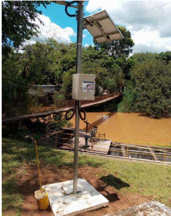
Estação Telemétrica Limpa (perto)
