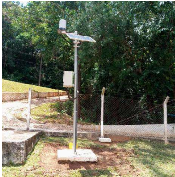
Estação Telemétrica Limpa (longe)
