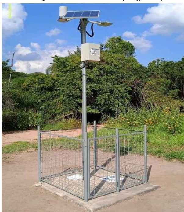
Estação Telemétrica Limpa (perto)
