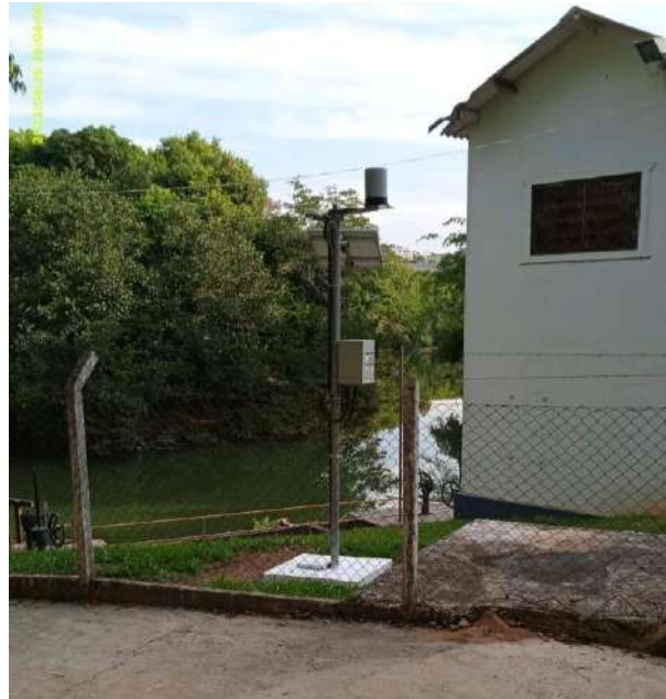
Estação Telemétrica Limpa (longe)
