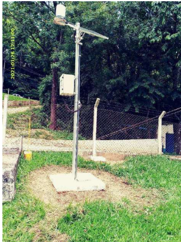
Estação Telemétrica Limpa (perto)
