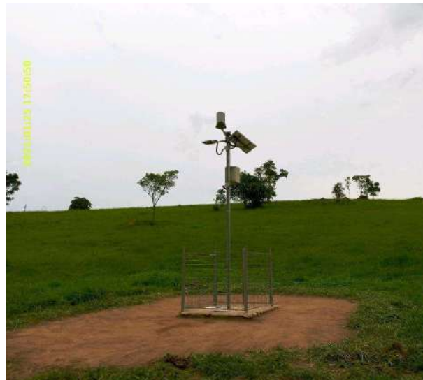
Estação Telemétrica Limpa (longe)
