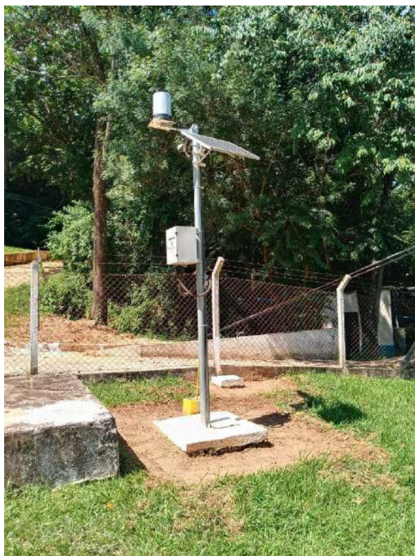
Estação Telemétrica Limpa (longe)
