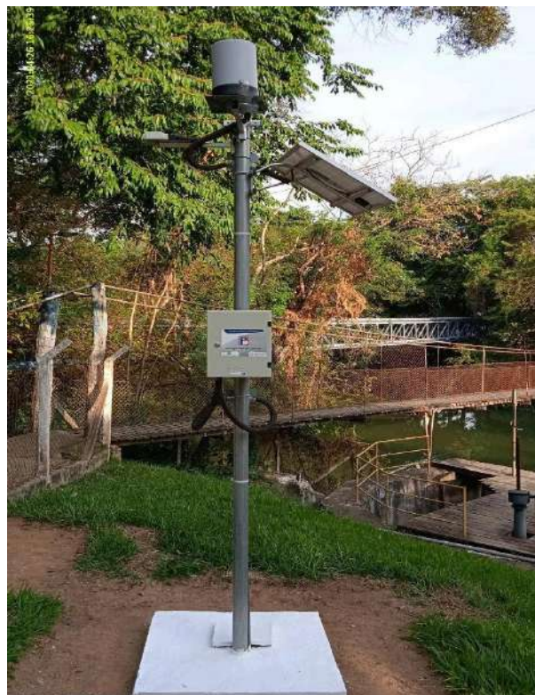
Estação Telemétrica Limpa (perto)
