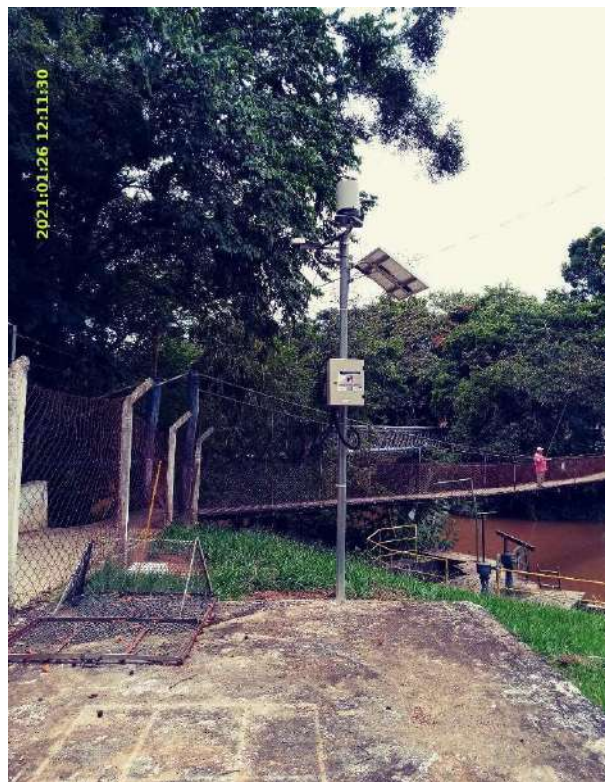
Estação Telemétrica Limpa (longe)
