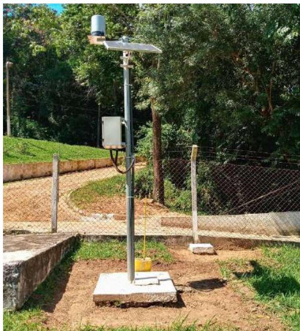
Estação Telemétrica Limpa (perto)
