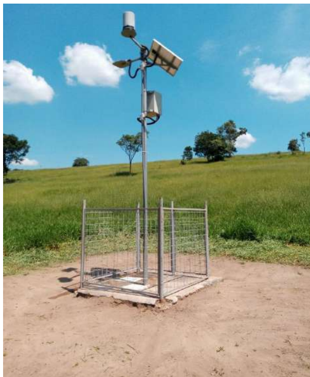
Estação Telemétrica Limpa (perto)
